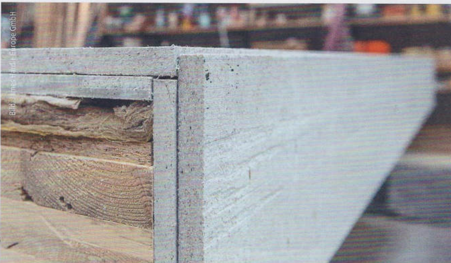
Alle Wohnungstrennwände und Trennwände zwischen den Nutzungseinheiten und anders genutzten Räumen werden gemäß Brandschutzgutachten als tragende Holzwände in F60-B und K260 Kapselung hergestellt. Sie sind doppelt beplankt mit 1 x 15 mm und 1 x 18 mm Gipsfaser-Platten, darunter eine Mineralwoll-Dämmung sowie eine 15 mm dicke Holzwerkstoffplatte.
