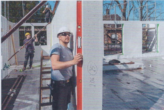
Die Montage ist aufgrund der millimetergenauen Vorfertigung und der Markierung von nur wenigen Fachkräften vor Ort zu bewerkstelligen..
